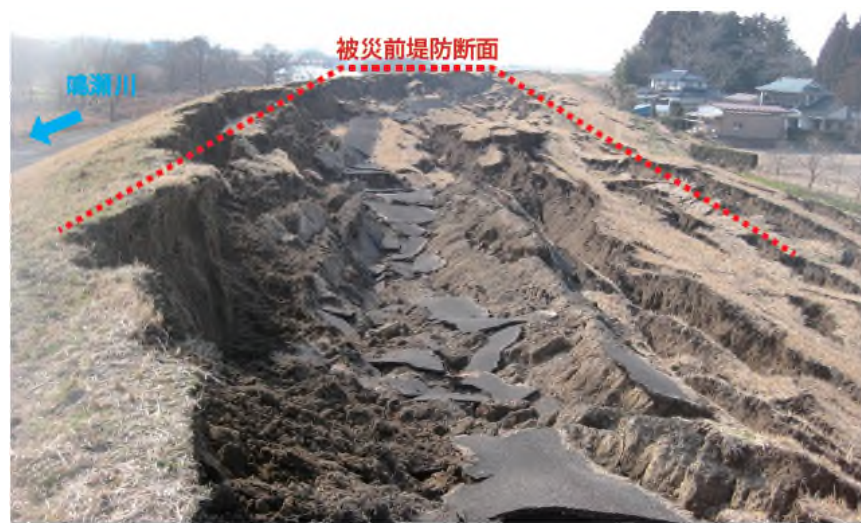
鳴瀬川の被災事例 (宮城県大崎市下中ノ目地先)
